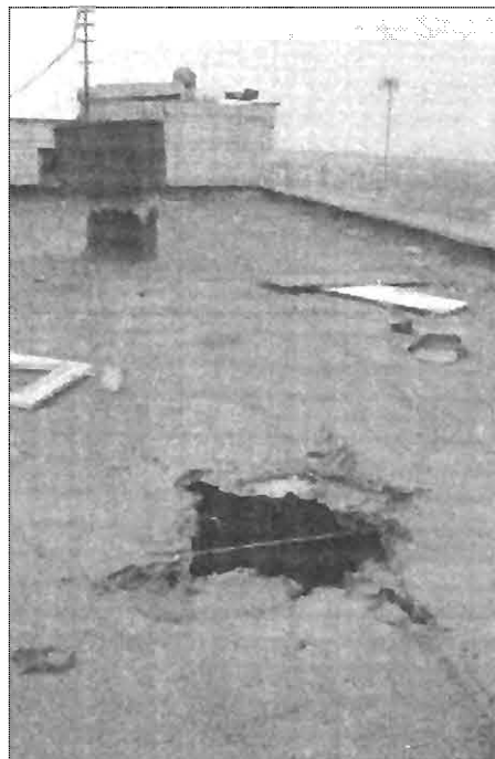
Дірка на даху житлового будинку в Броварах Київської області.
